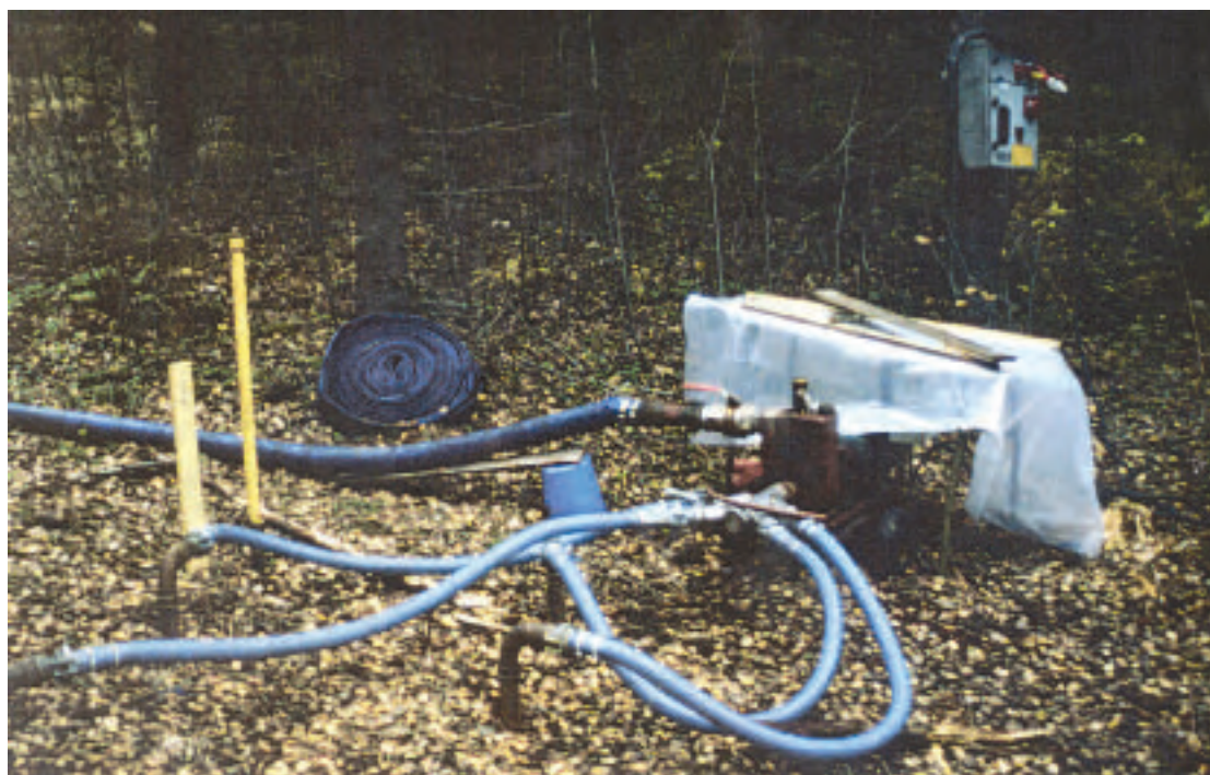
Kuva 4.1.3a. Imusarjalla tehty koepumppaus. Etualalla imuputket (4 kpl), oikealla sähkökäyttöinen itseimevä pumppu, jonka sähköliittymä on oikeassa yläkulmassa. Pumpusta vasemmalle lähtee poistoputki. Poistoputken ja pumpun välissä on näytteenottohana. Kuva T. Kinnunen.
